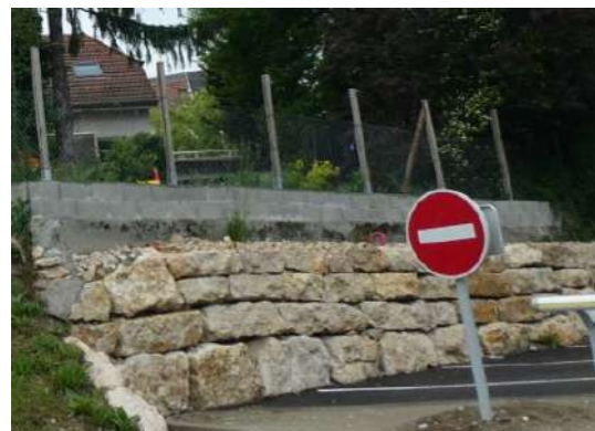
Soutènements : les enrochements, murs cyclopéens ne sont pas du tout adaptés au paysage urbain. Ce sont des techniques en usage pour des infrastructures routières. Ils ne sont pas du tout à l'échelle de la ville et contribuent à banaliser le paysage.
