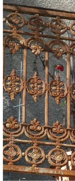
Fonte (rouillée) sur balcon de pierre Belle Époque, rue Roose-
