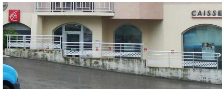
Clôture style garde-corps années 90.
