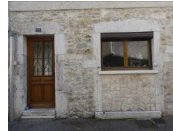
condamnation de porte avec une fenêtre standard et une allège maçonnée (malgré la volonté de bien faire en utilisant la pierre)
