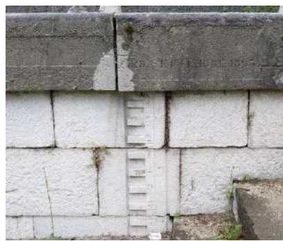
Échelle altimétrique de crue du Rhône
