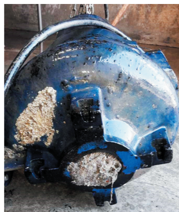
Photo d'une pompe bouchée
