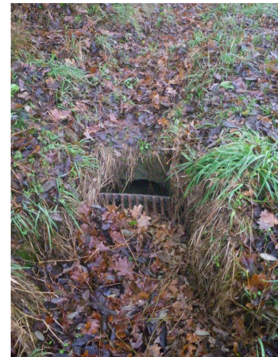
Grille quasi obstruée en amont d'un passage busé
