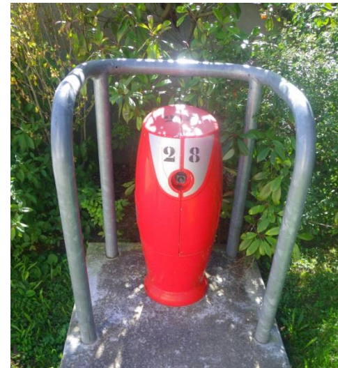
Poteau d'incendie numéroté sur Desingy
