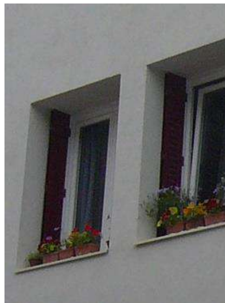
NON – panneaux isolants qui masquent la modénature de la façade et créent une surépaisseur et diminuent par force la surface vitrée
