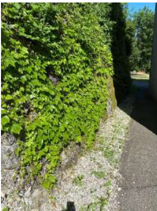
Clermont : pied de mur perméable
