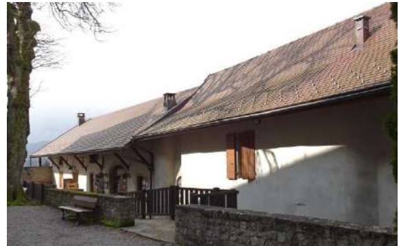
Les communs du château, tuiles écaillées
