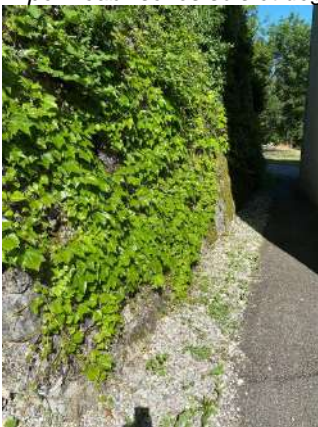
Clermont : pied de mur perméable
