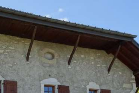
ventilation de la grange
