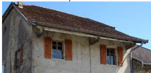
Le débord de toit est supporté par les poutres horizontales traversant la maçonnerie
