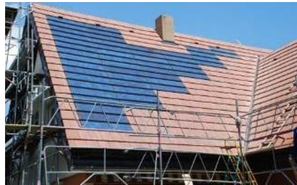
Non respect des ouvertures et des lignes de la toiture ce qui crée un « trou »
