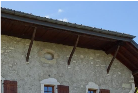
ventilation de la grange
