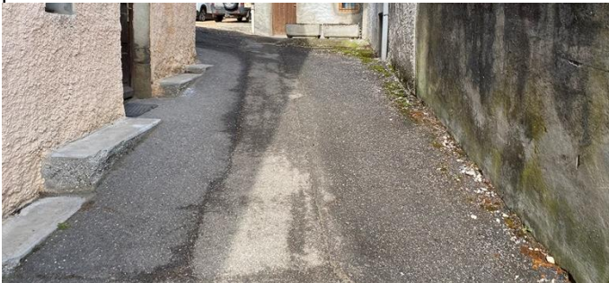
Clermont, Passage du Vieux Village: Enrobé recouvrant tout l'espace, jusqu'au pied des façades, qui unifie l'espace public et lui donne un caractère routier, altère les perceptions visuelles et ne participe pas à la mise en valeur du patrimoine bâti, imperméabilise les sols et dégrade les murs anciens
